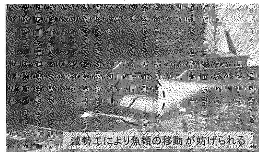
図 8 益田ダムの減勢工
